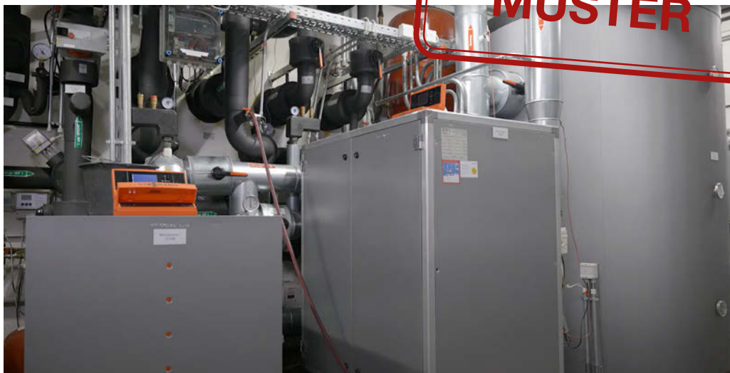
Die Heizanlage nutzt geothermische Wärme aus einer 800 Meter tiefen Bohrung.
