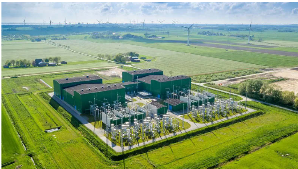
Die NordLink-Konverterstation im schleswig-holsteinischen Wilster. Über den Interconnector ist die Region mit der Strompreiszone N02 in Norwegen verbunden.
